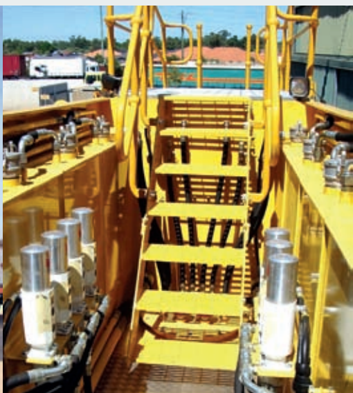
Camião de serviço, bombas de óleo PM4.
